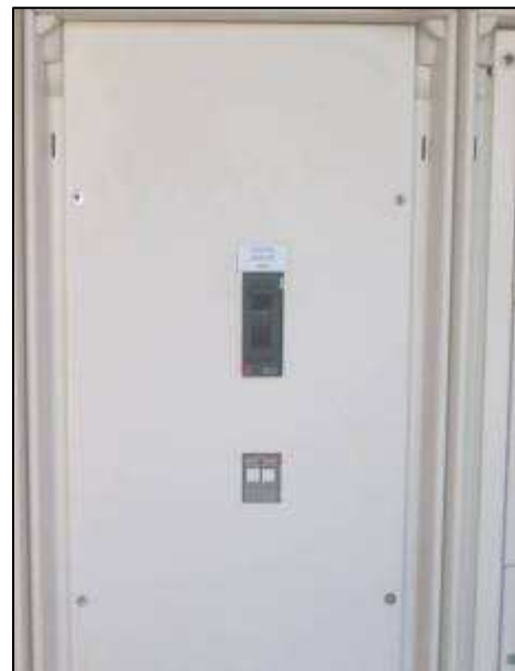
Disjoncteur arrivée BT
