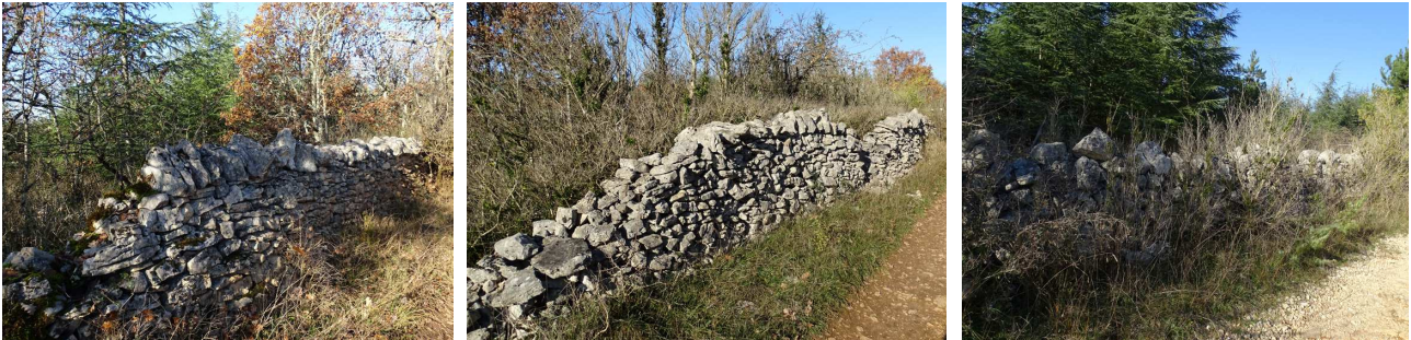
Un réseau de murets en pierre sèche, typique des paysages du Quercy, ceinture le site de projet. Par manque d'entretien, les linéaires sont discontinus, largement dégradés et tendent à disparaître sous la végétation
